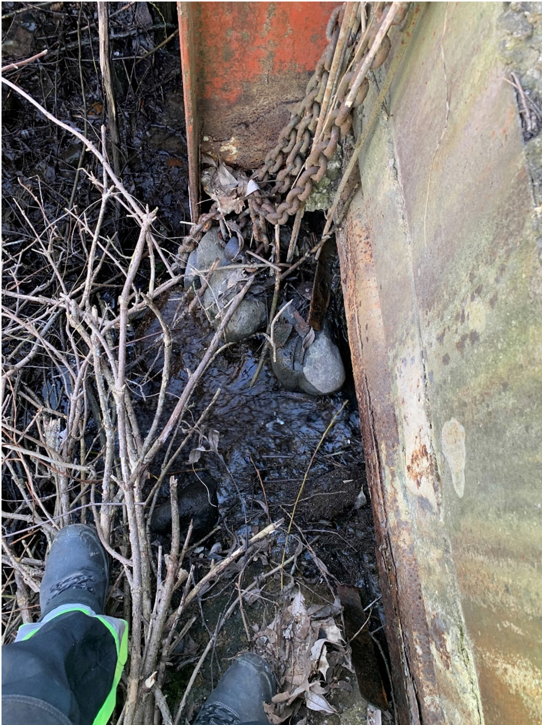
Foto 2 – Anm. 1 Läckage på vänster sida nedströms luckan
