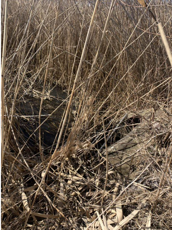
Figur 17. Inlopp till kulvert/vägtrumma i den nedströms delen av Blackbäcken med mycket växtlighet. Bilden är tagen ca 1,2 km nedströms dammen. Foto: Tyréns.
