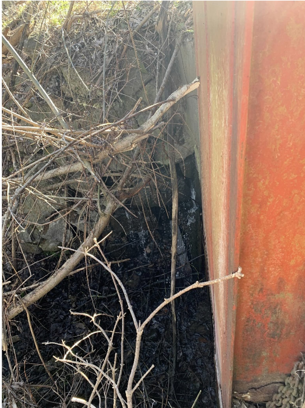
Foto 1. Anm. 1 – Läckage höger sida nedströms luckan.
