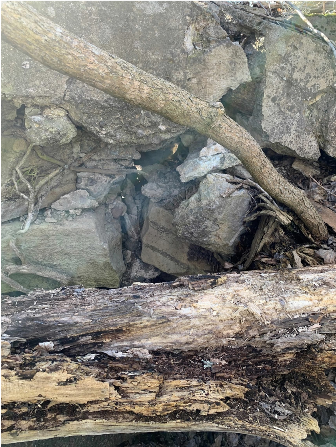
Foto 5 - Anm. 3 Kollaps av murverk och fyllningsdamm.
