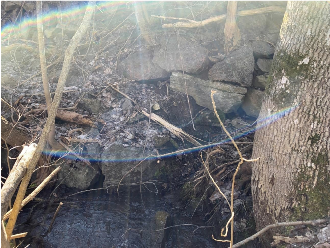
Foto 4 – Anm. 3 Kollaps av murverk och fyllningsdamm.
