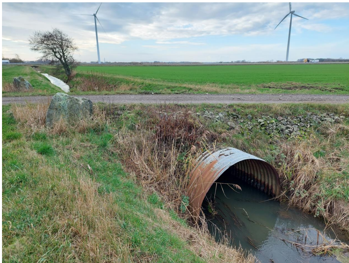
Figur 25. Markavvattningsdike och trumma i den västra delen av verksamhetsområdet med E6/E20 och Torebo vindkraftspark i bakgrunden.
