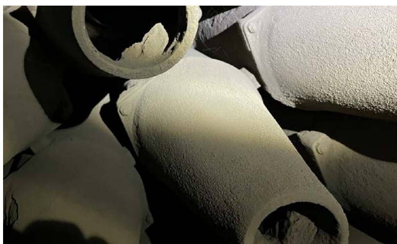
Figur 1 Bilden visar hålen där aska kommer ut ur cyklonen. En del av dem är rensade och en del är igensatta
