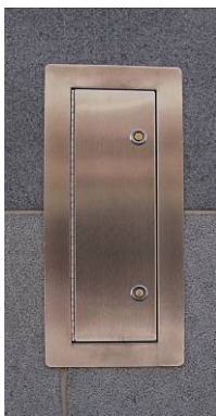
1. Infälld säkringscentral med rostfri front.
