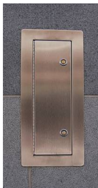
1. Infälld säkringscentral med rostfri front.
