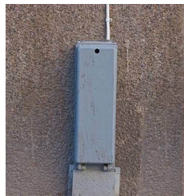
2. Utanpåliggande säkringscentral, GAROs sk "Göteborgsdosa" i gjuten silumin.
