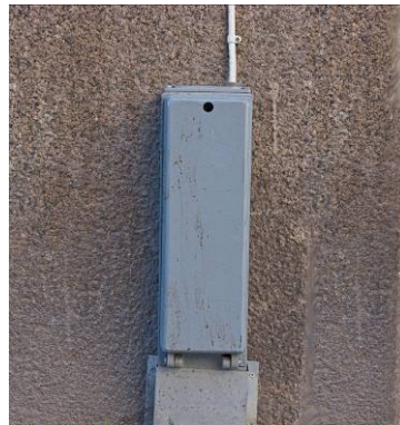
Utanpåliggande säkringscentral sk "Göteborgsdosa"
