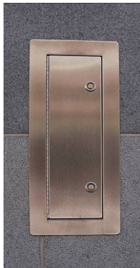
Infälld säkringscentral med rostfri front
