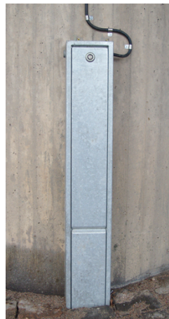
Säkringscentral, sk "Larssonskåp"
