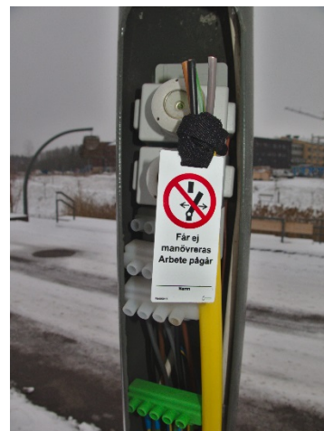
Skylt "Får ej manövreras Arbete pågår". Dock utan mobilnummer.
